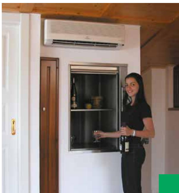
Installazione in una casa privata (Italia), modello 24 kg con finiture in acciaio inox. Grazie al Microlift il trasporto della spesa dal garage alla cucina non è più un problema.
